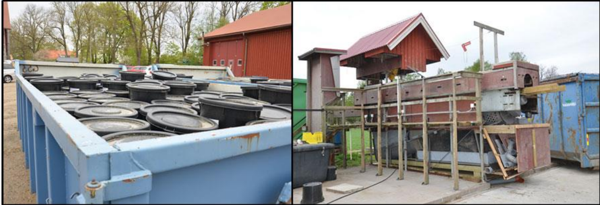
Uppställningsplats för latrintunnor och tömningsautomaten för latrintunnorna.
