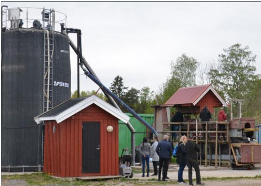
Delar av Sörby gårds anläggning för våtkompostering. Anläggningen från vänster med reaktorns torn, den röda teknikboden, samt tömningsautomaten för latrin med rött tak som många var nyfikna på. Den underjordiska mottagningsstanken med biofiltret är placerad mellan den röda teknikboden och tömningsautomaten och syns inte på bilden.
