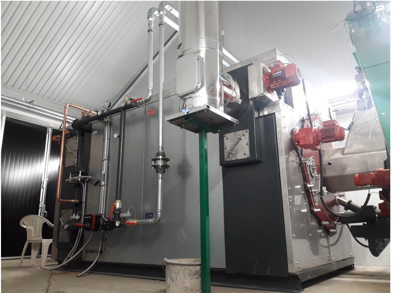
Anläggning med pyrolysuugn och brännugn för pyrolysgaser
