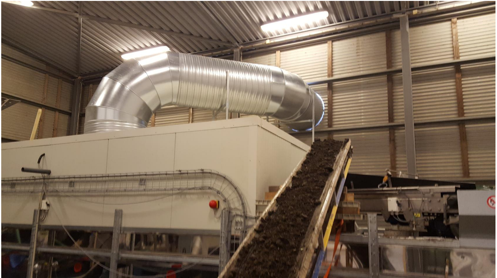
Bandtork med inmatning och avluftning. Pilotprojekt i Helsingborg.
