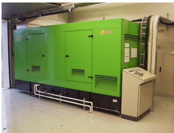
Figur 6 - Reservdiesel vid Fredriksbergs vattenverk
