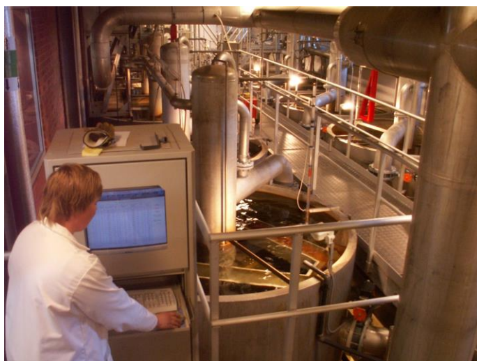
Figur 5 - Fredriksbergs vattenverk i Oskarshamn
