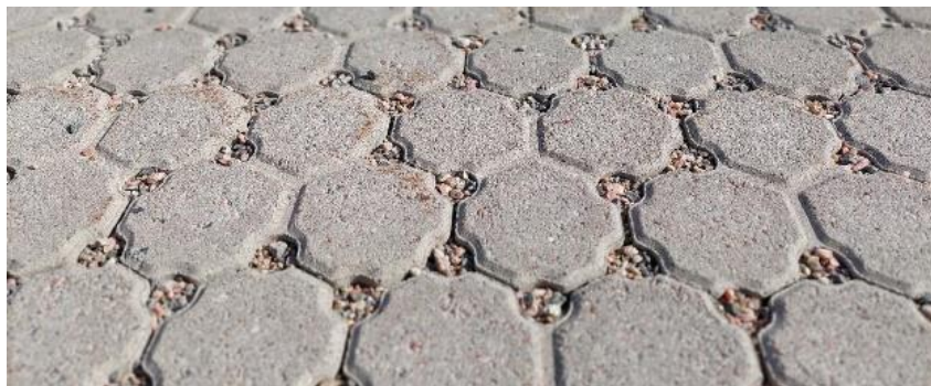
Figur 2. Exempel på dränerande markstensbeläggning. Fogarean bör utgöra minst 8 - 10 av ytan. Foto: Svensk Markbetong
