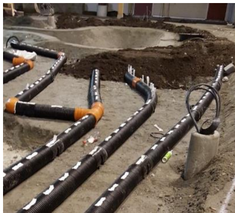
Figur 1. Savaq i anläggningsskedet. De vita vekarna som syns på toppen av rören suger via kapillärkraftupp vatten till växtbädden och sedan vidare via jordens egen kapillärkraft till rötterna på växterna. Foto: Ponova
