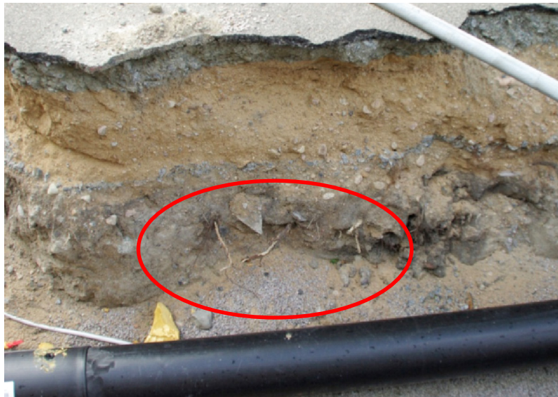
Figur 2-4 Bild på trädrötter som växer i en ledningsgrav (foto av Örjan Stål).
