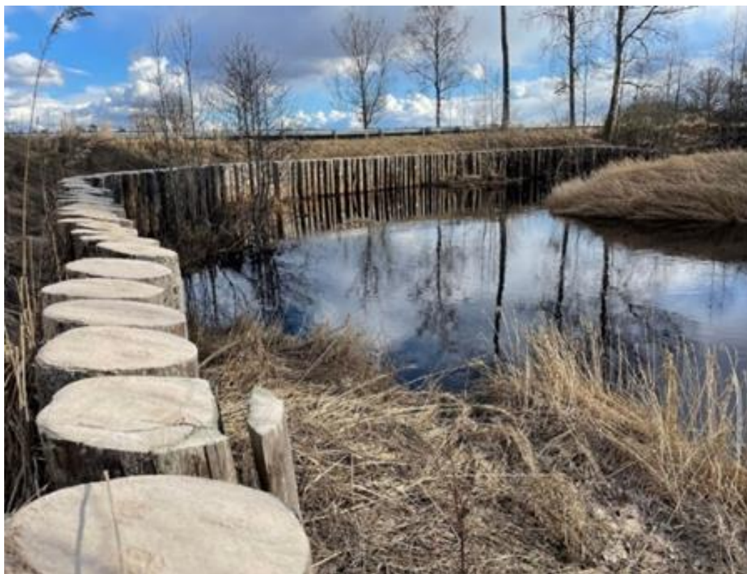
Figur 9 Träpalissad i vattendrag. Klimatanpassningsåtgärden är ett erosionsskydd ca 4 meter från vägen i form av en ca 65 meter lång träpalissad. (Foto: Simon Agnesson, Trafikverket)
