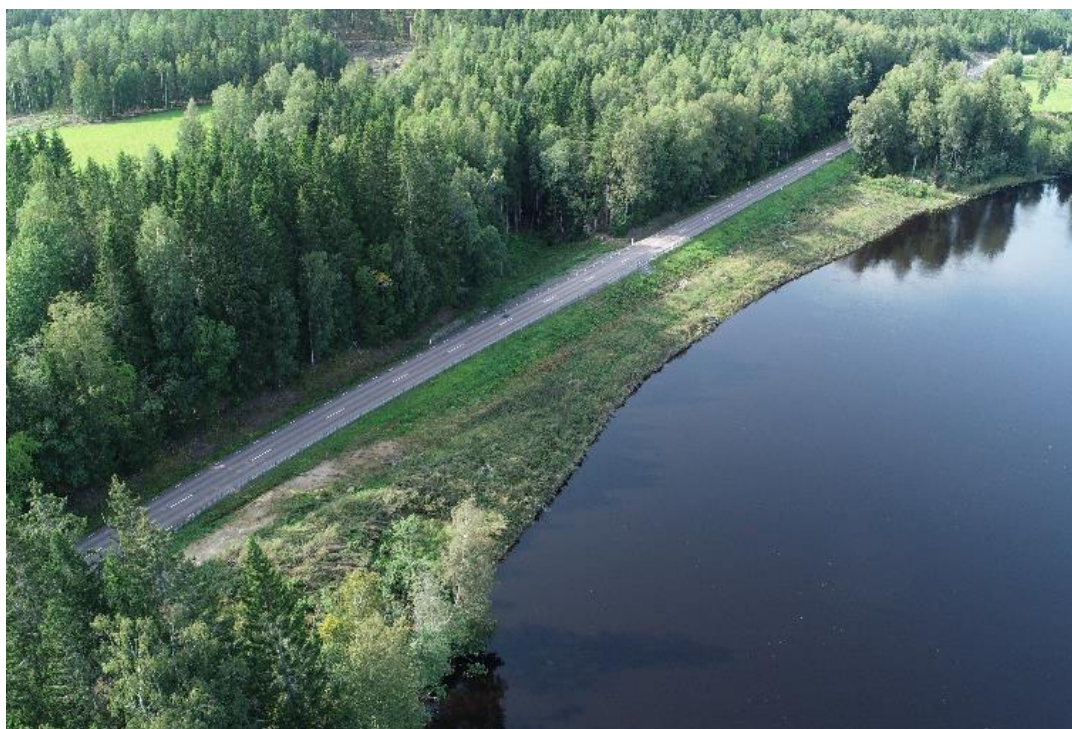
Figur 4 Drönarbild över tryckbank och erosionsskydd vid Älvkullen 2023. Skyddet blev klart i november 2021. (Källa: Trafikverket)
