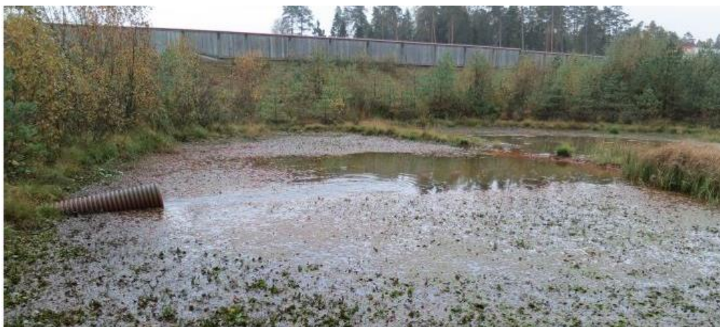
Figur 14. I denna damm vid E4 (Pinnån/Sköndal) hindrar vegetationen ett jämnt flöde genom dammen. Vegetationen behöver åtgärdas. Bilden är tagen i samband med inspektion 2014.
