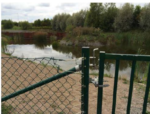
Figur 26. Stängslet på bilden är trasigt och behöver åtgärdas. Bilden är tagen vid damm vid Gamla Uppsalagatan i samband med inspektion 2014.
