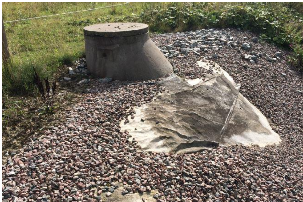
Figur 23. Täckskiktet på bilden är trasigt och behöver repareras. Bilden är tagen vid damm vid Fyrisån i samband med inspektion 2014.
