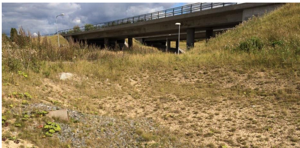
Figur 15. Vid inspektion av denna damm vid Fyrisån 2014 var dammen torrlagd. Orsaken till detta behöver utredas för att fastställa lämpliga åtgärder.
