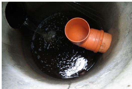
Figur 25. Oljeavskiljare vid utloppet av dagvattendamm vid Havabygget 2014.
