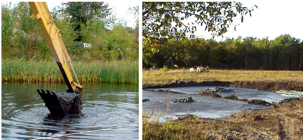
Figur 32. T.v. Grävmaskin kan fungera för att ta upp sediment. Det finns också skopor med hål som tillåter att vattnet till viss del rinner av direkt vid grävning. Är de uppgrävda massorna mycket blöta kan de behöva avvattnas. T.h. En enkel avvattning av massorna kan göras genom utbredning av dem på ett invallat område som avvattnas till befintlig damm.
