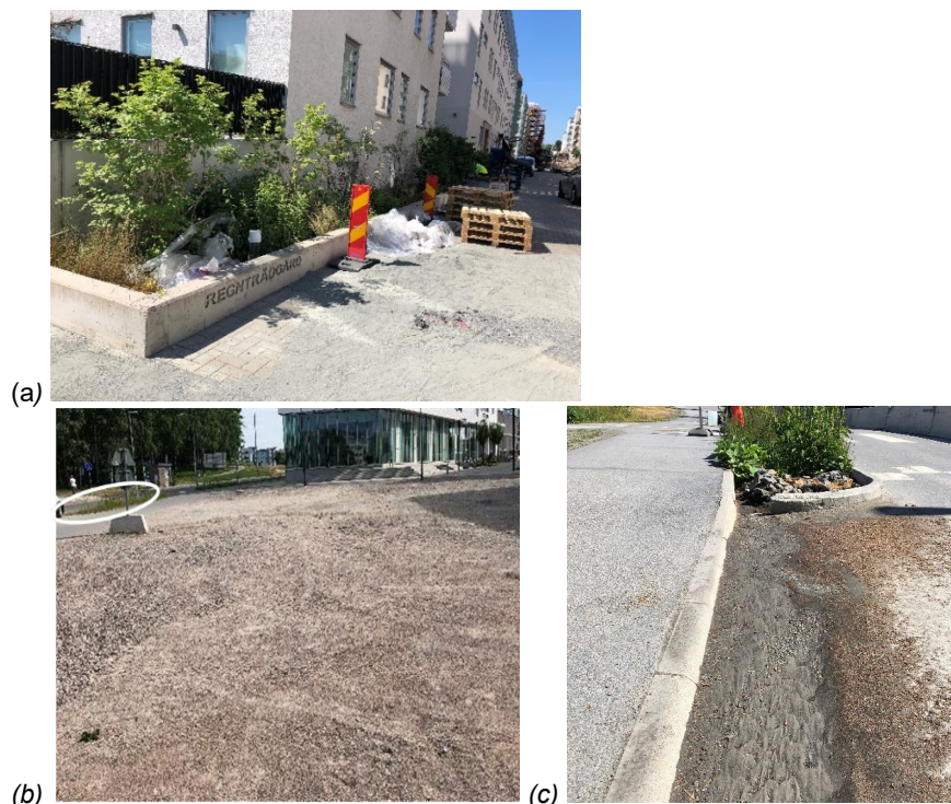
Figur 1. (a) Biofilter med avlagring av byggavfall. (b) grusyta som del av avrinningsområde till ett biofilter (filtrets placering visas av den vita cirkeln). (c) byggarbete som bidrar med mycket sediment till biofiltret
