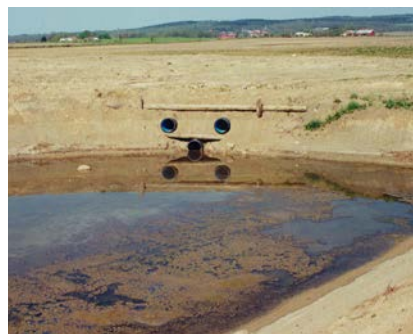
Utjämningsmagasin i Halland med utloppsrör på olika nivåer.
