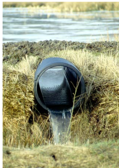
Ett säkerhetsrör med för lite jord ovanpå. Det krävs 60 cm täckning för att förhindra tjälskjutning och körskador.
