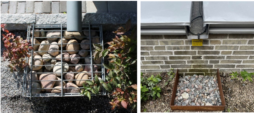
Bild. Erosionsskyddets funktion i en regnbädd är att förhindra att inloppsområdet skadas av vattenflödet när dagvatten rinner in i anläggningen.
