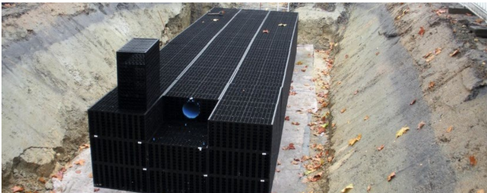
Brunnsbeteckning till dagvattenmagasinet (TV). Brunn med bräddfunktion samt sandfång (TH). Kassettmoduler som utgör dagvattenmagasinet som placeras under mark (nedre bild).
